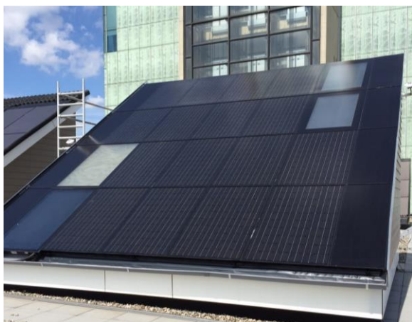
Figuur 3. Prototype AER dak op de SolarBEAT testlocatie op de TU/e campus in Eindhoven.
